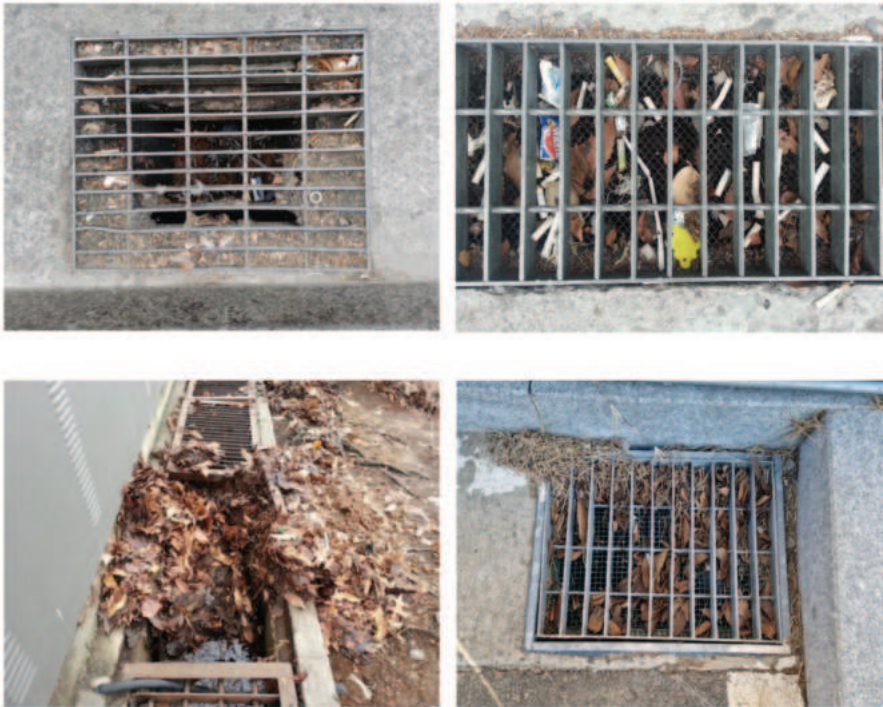
배수로 내부 쓰레기 유입 (시공전)
